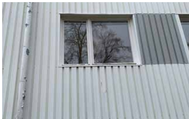
Sälgen. Underhållsbehov av fönster och flagande färg på stuprör.
