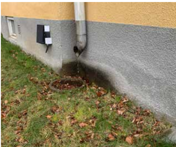
Enen. Bristande dagvattenavledning och fuktuppslag på fasad.
