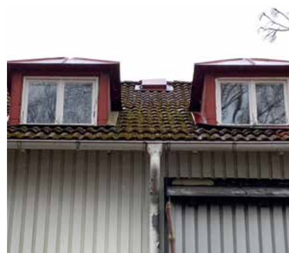
Sälgen. Mosspåväxt på tak samt underhållsbehov av takplåt, fönster och plåt i fasad.
