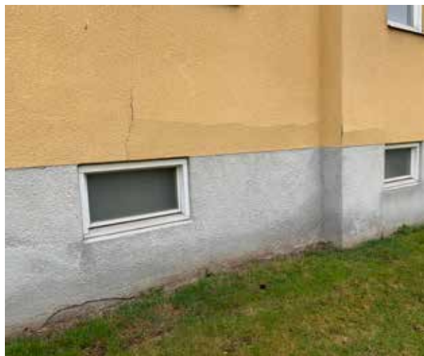
Videt. Bom och sprickor i putsen samt putsbortfall.
