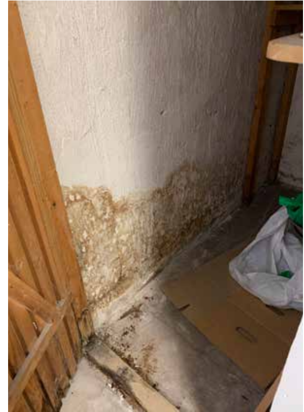
Videt. Fuktskador i yttervägg i källare.
